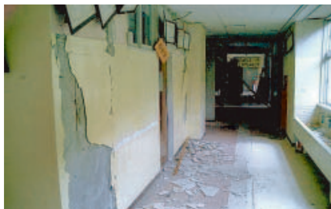
被災現場(小学校)
